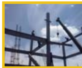
Hotel Galería Plaza Insurgentes: Construcción de fachada a base de estructura metálica y techumbre de lámina.
